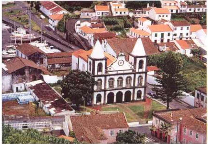
Igreja das Angústias (Horta) encerrada ao culto. Apresenta danos importantes, alguns na sequência do sismo da década de 20, agora agravados
