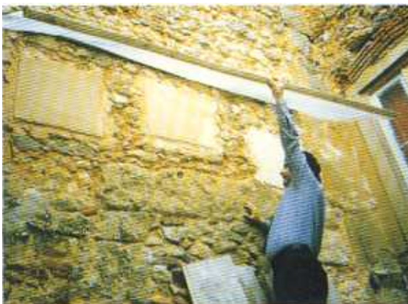
Painéis experimentais de pequena dimensão de reboco de cal executados no contraforte da Torre do Relógio.
