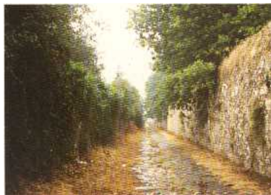
Mosteiro de S. Martinho de Tibães – Muro da cerca, argamassas degradadas e desconsolidadas.
