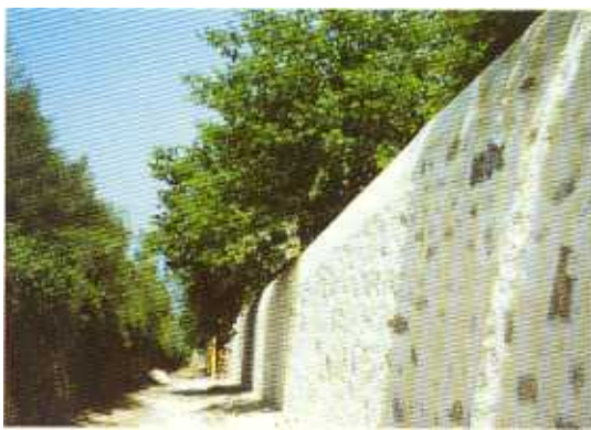
Mosteiro de S. Martinho de Tibães – Muro da cerca, após aplicação de argamassas de suporte, consolidação e revestimento.
