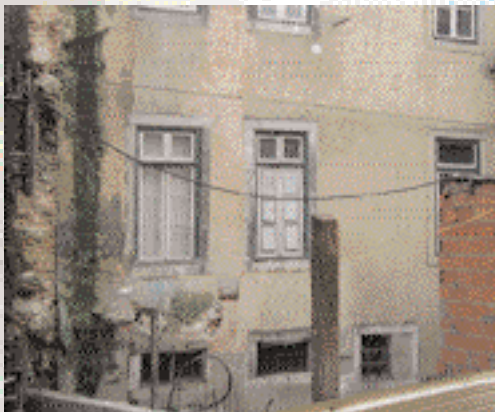
Vista da fachada posterior na zona mais afectada pelos assentamentos
