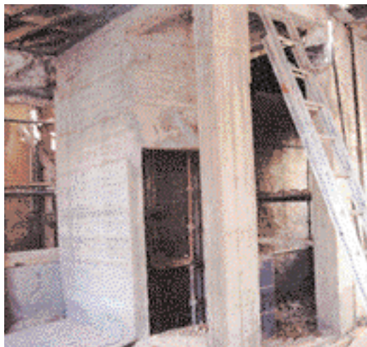
Estrutura de betão na zona das novas caixas de escadas e elevadores
