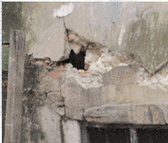
Pormenor do esmagamento da parede de tardo, junto à base
