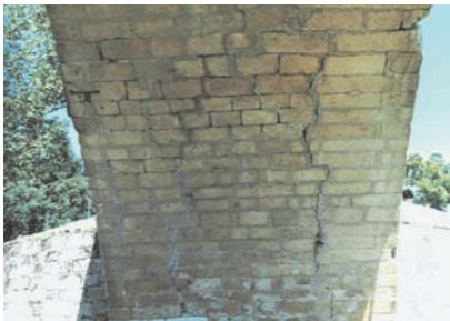
Ponte-velha de Mirandela. Fendilhação extremamente pronunciada numa das abóbadas.
