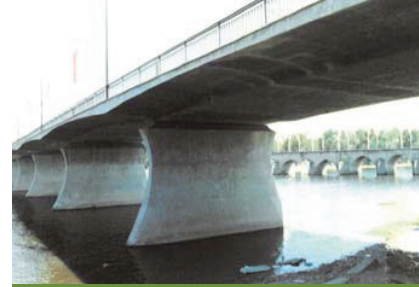
Ponte-velha de Mirandela, (ao fundo à direita.) Alçado visto da ponte nova.
