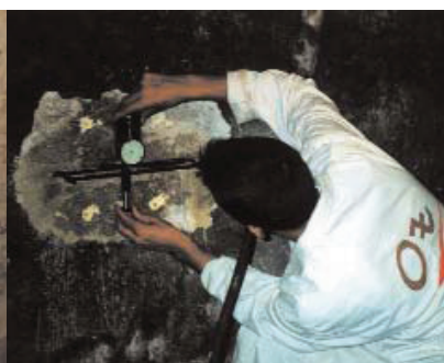
Medição das deformações da alvenaria durante a determinação do estado de tensão.
