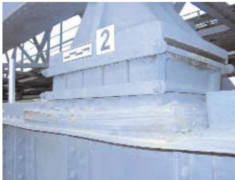
Figura 2 - Corrosão na base do aparelho de apoio no pilar.
