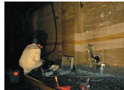
Figura 3 - Medição de intensidade de corrosão e do potencial eléctrico das armaduras numa zona de ensaios localizada na parede lateral no túnel.
