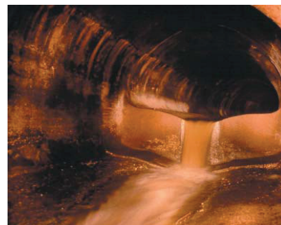
Figura 1: Secção do caneiro sob a actual Avenida de Ceuta (fotografia gentilmente cedida pela Eng.ª Maria do Céu Almeida, LNEC).
