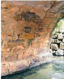
Aspecto do mau comportamento das argamassas à base de cimento Portland aplicadas no intradorso de um dos arcos
