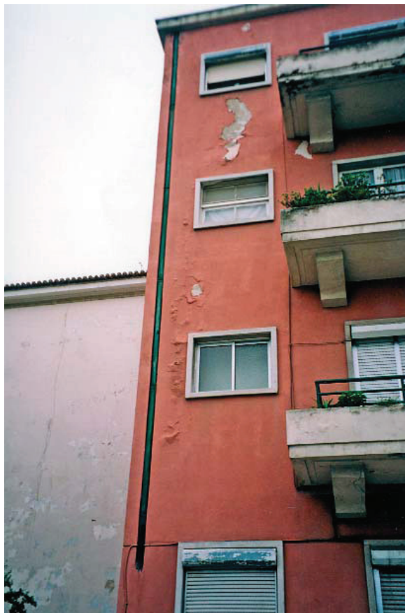
Formação de empolamentos e destruição de rebocos por aplicação do sistema de pintura impermeável ao vapor em obra de reabilitação.
