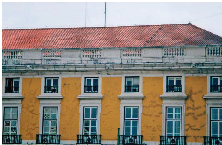
Manchas em paredes reparadas e pintadas por incompatibilidade dos materiais aplicados.
