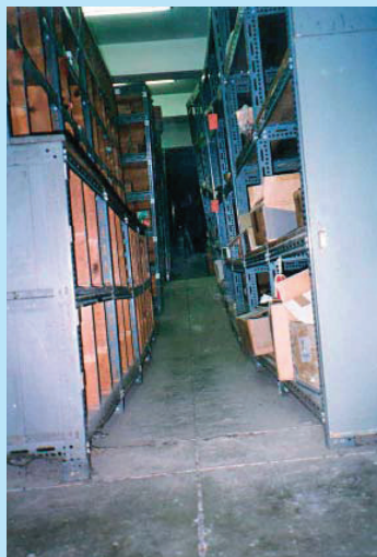
Foto 2: Deformação excessiva da Laje. Quantificação inadequada das acções.
