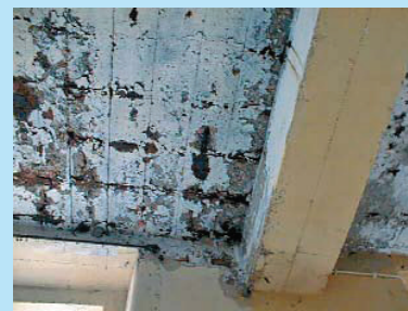
Foto 3: Corrosão das armaduras. Espessura de recobrimento insuficiente.
