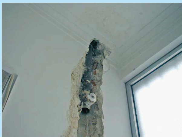
Foto 7: Infiltração de humidade. Dimensionamento inadequado das tubagens.
