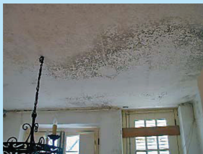
Foto 1: Infiltração de humidade. Deficiente pormenorização das ligações e remates da tela de impermeabilização subjacente.
