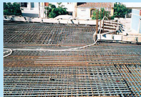
Foto 6: Mau dimensionamento. Excesso de armadura.
