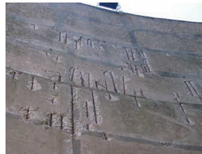
Corrosão de armaduras com delaminação de betão
