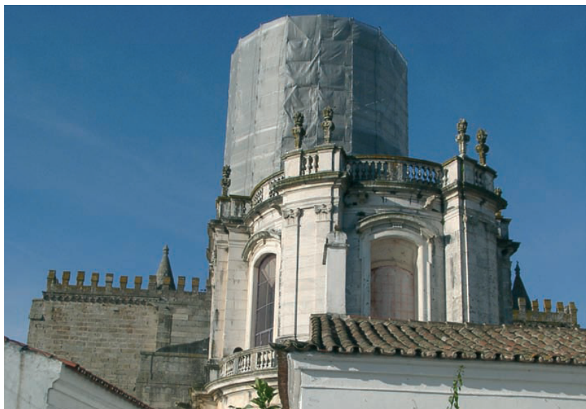
Zimbório da Sé recoberto pelos andaimes: preocupação estética no tratamento da envolvente da obra e do seu impacto na cidade património mundial
