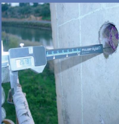
Medição da profundidade de carbonatação do betão após aspersão da solução alcoólica de fenolftaleína
