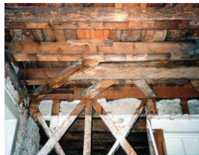
4 - Peças de ligação piso/frontal quando este é paralelo aos barrotos do pavimento
