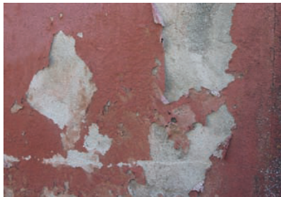
Empolamento e destaque de pintura não adequada a rebocos de argamassa com base em cal aérea
