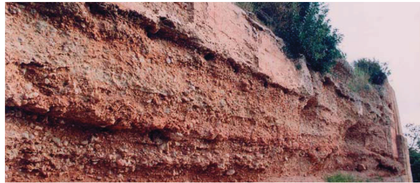
4. Erosão profunda, produzida pela acção conjugada de vários agentes. Nota-se, também, a infestação por plantas de porte variável
