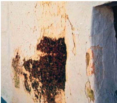
2. Erosão de parede de taipa pela água da chuva devido a falta de manutenção (renovação periódica da caiação)
