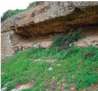
3. Instabilização da parede provocada por erosão profunda
