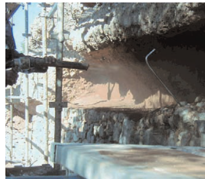
9. Castelo de Paderna: preenchimento de uma lacuna de grandes dimensões com terra projectada
