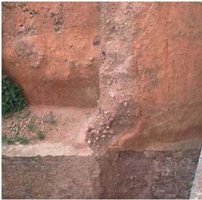
1. Erosão de parede de taipa pela água da chuva
