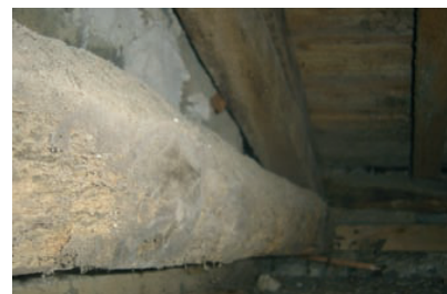
4 - Cobertura - ataque pontual e superficial de térmitas num barrote horizontal
