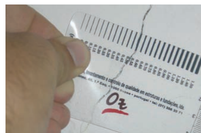
3 - Medição da abertura de uma fissura com um simples comparador de espessuras
