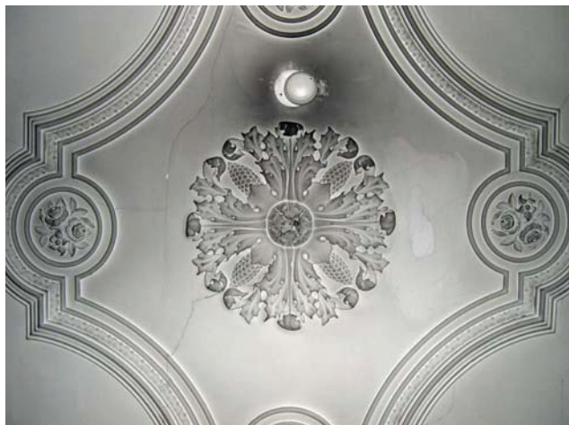
Figura 4. Sujidade provocada por detector de incêndio. Palácio do Marquês de Tomar. Lisboa.
