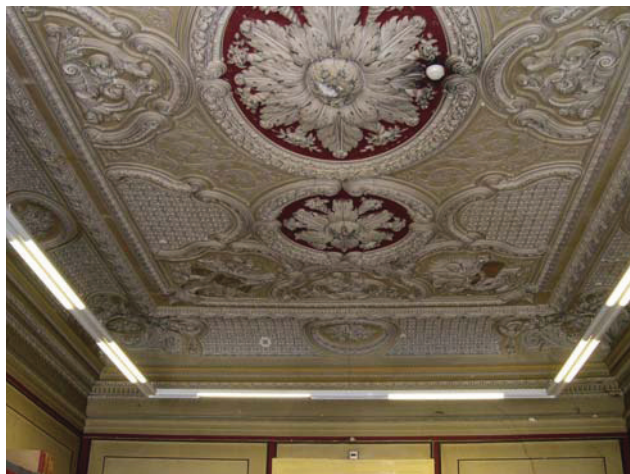
Figura 2. Iluminação e detector de incêndio sem integração no local. Palácio do Marquês de Tomar. Lisboa.
