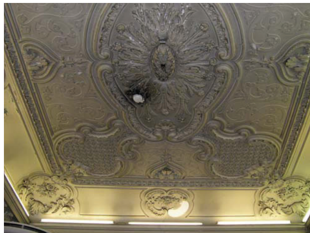
Figura 5. Sujidade provocada por detector de incêndio. Palácio do Marquês de Tomar. Lisboa.
