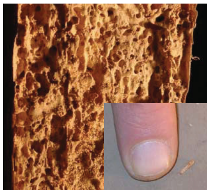
Figura 5 - Ataque de formiga branca em viga de madeira
