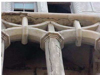
4 – Sintomas muito severos de corrosão das armaduras
