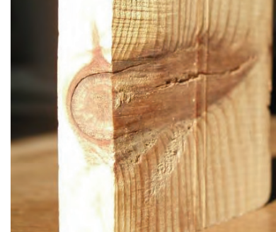
Os nós correspondem a fibras perpendiculares ao eixo da peça de madeira
