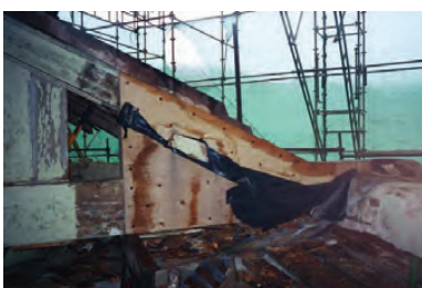
Fases de recuperação do apoio da asna
