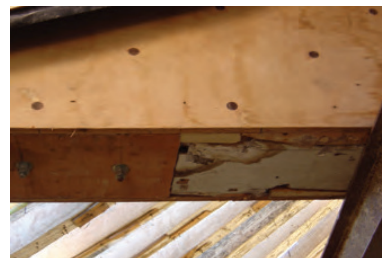
Fases de recuperação do apoio da asna
