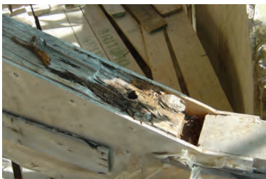
Apoio de asna degradada
