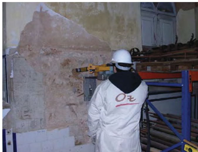
Fig. 3 – Realização do corte numa parede resistente de alvenaria de pedra para a realização de ensaios de macacos planos
