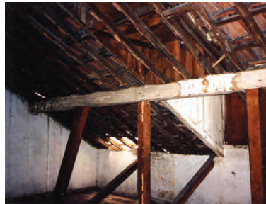
Fig. 2 - Degradação acentuada da estrutura em madeira da cobertura
