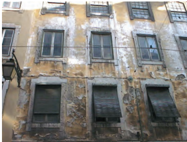
Fig. 1 - Degradação do revestimento da fachada
