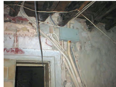
Fig. 3 - Pormenor de instalações eléctricas novas num edifício antigo
