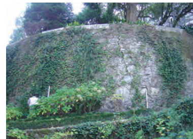
Fig. 2 – Muro em curva. Fenda com cerca de 5cm de abertura e ausência de revestimento
