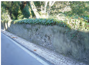
Fig. 1 – Muro contíguo à Rua Visconde de Monserrate. Lacunas na alvenaria
