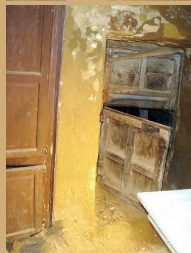
Fig. 3 - Anexo da capela-mor. Deposição da areia do reboco devido a desagregação intensa
