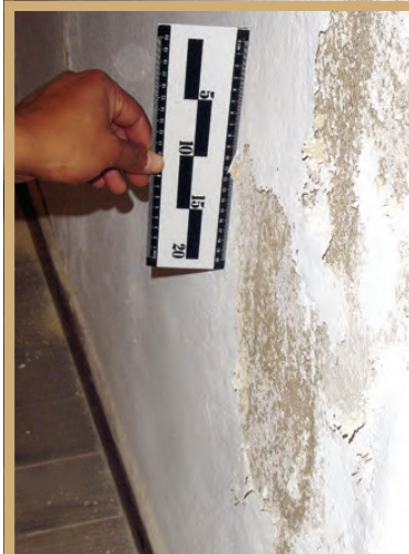
Fig. 2 - Coro alto. Pormenor da parede de fachada evidenciando a presença de eflorescências
