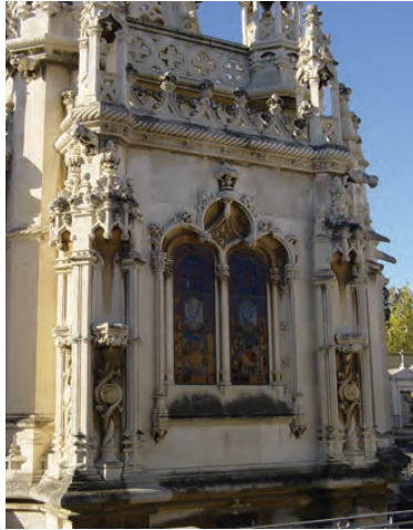
2 - Pormenor da fachada lateral e vitral, antes da intervenção
