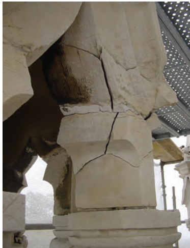
3 - Fractura e delaminação em colunelo do coruchéu, provocada por oxidação de varão metálico interior
