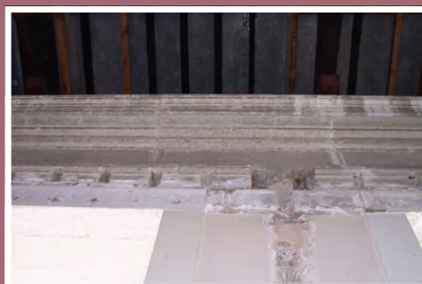
Sanca de cantaria por restaurar
