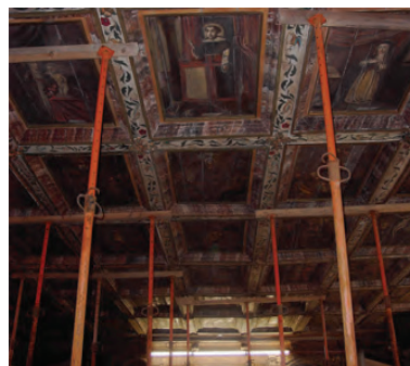
2 - Aspectos do estado de degradação do edifício
