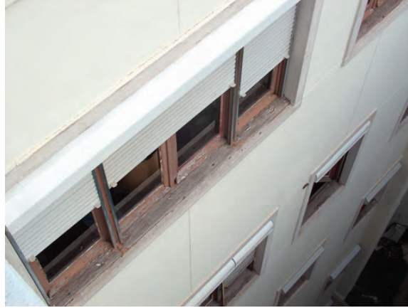
3 - Anomalia. Tipologia: deficiências ou lacunas na pintura; localização: caixilhos de madeira; extensão: elevada; urgência na reparação: máxima
