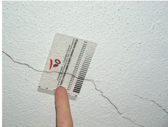
5 - Anomalia: fissuração (0,85mm); localização: laje de suporte; extensão: média; urgência na reparação: máxima
