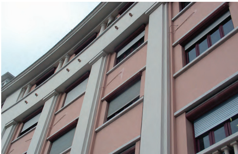
1 - Anomalia. Tipologia: deficiências ou lacunas na pintura; localização: parede, junto aos tubos; extensão: média; urgência na reparação: mínima
