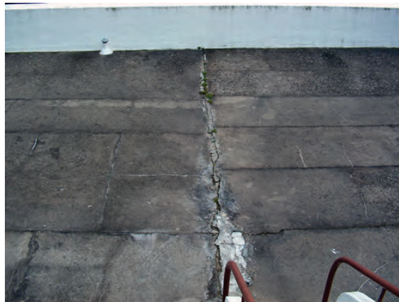
7 - Anomalia. Tipologia: humidade excessiva; localização: tecto; extensão: média; urgência na reparação: máxima
