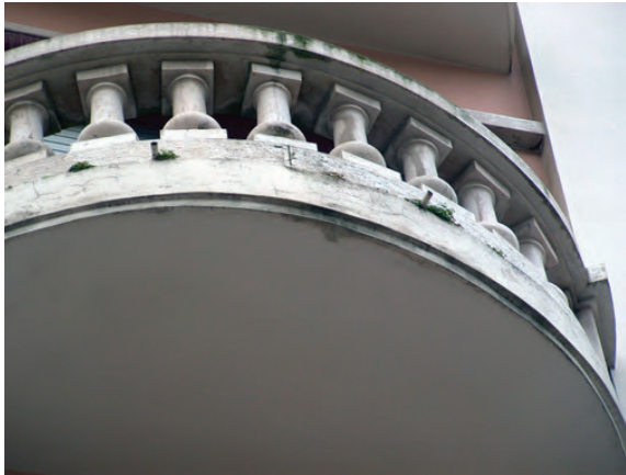
4 - Anomalia. Tipologia: vegetação; localização: junto das pedras e capeamentos; extensão: elevada; urgência na reparação: máxima
