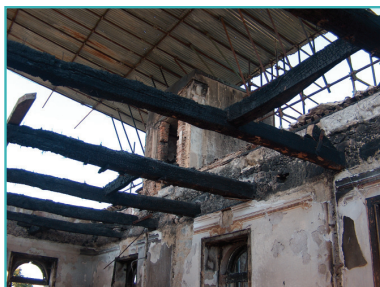
2 - Aspecto da estrutura após o incêndio.
