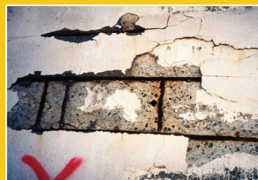
Área mostrando severa deterioração assinalada para remoção de betão.
