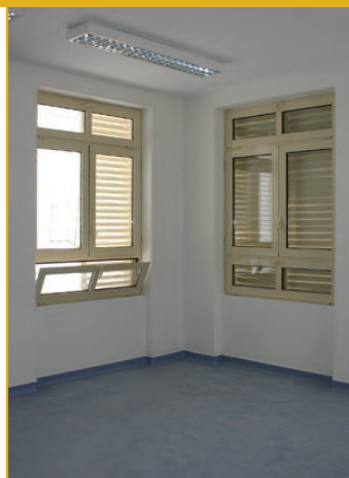
Caixilharia e estore exteriores.
