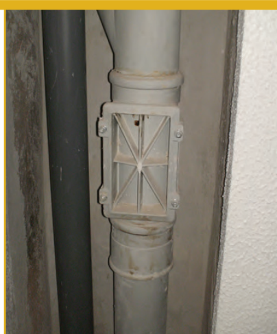
Boca de limpeza.
