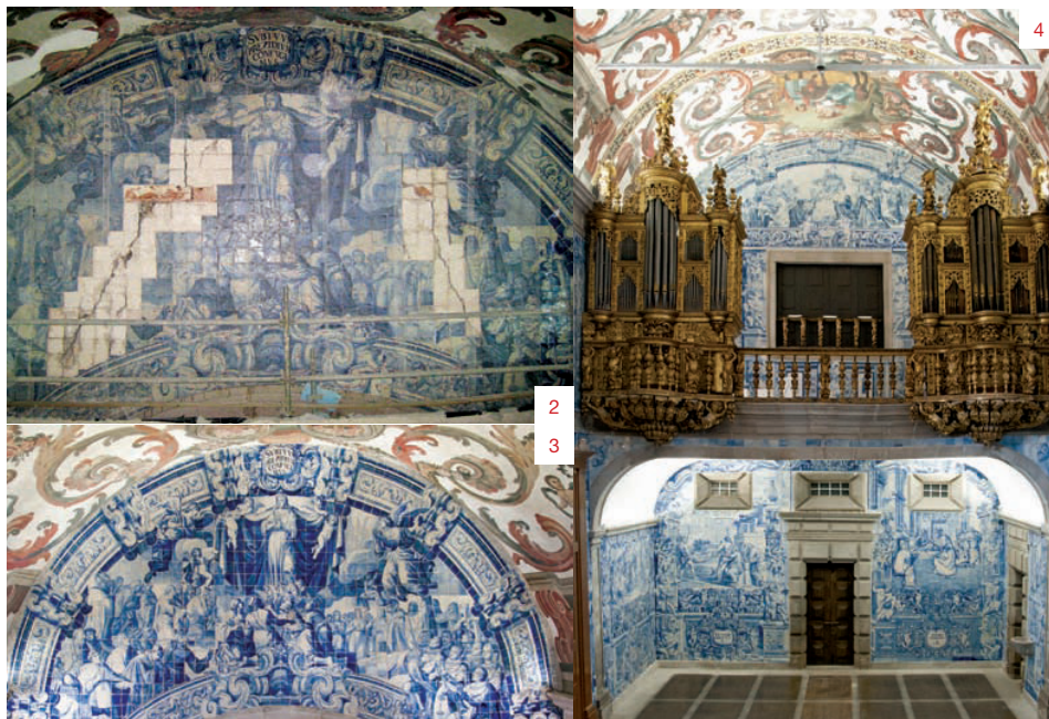
2 | Azulejos do arco cruzeiro antes da intervenção.
